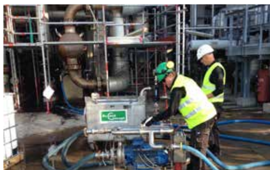
Rengöringen av anläggningarna sker i ett slutet system.
